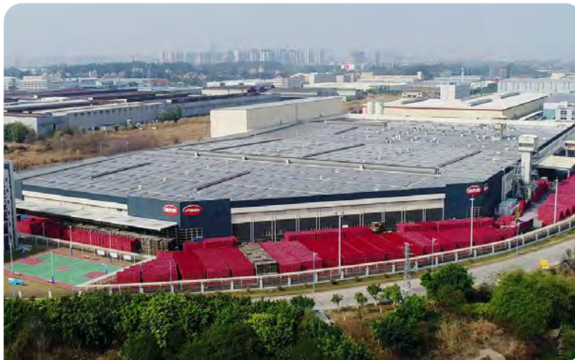
於佛山廠天台的太陽能電池板
